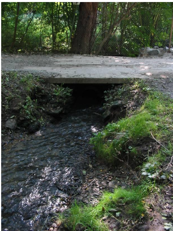
Obr. 19 odběrový bod VII, potok opouštějící mokřad před mostkem, následně vtékající na soukromý pozemek Dražanského mlýna , září 2010
